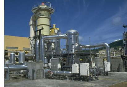
Centrale géothermique de Bouillante (Guadeloupe) Capacité : 15 MW
