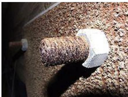
Corrosion différenciée sur deux métaux plus et moins oxydables
