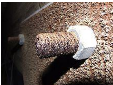
Corrosion différenciée sur deux métaux plus et moins oxydables
