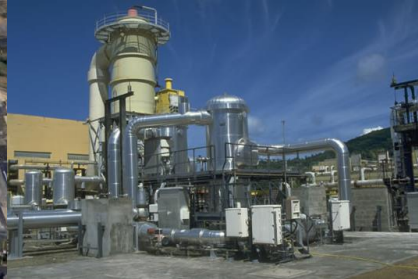
Centrale géothermique de Bouillante (Guadeloupe) Capacité : 15 MW
